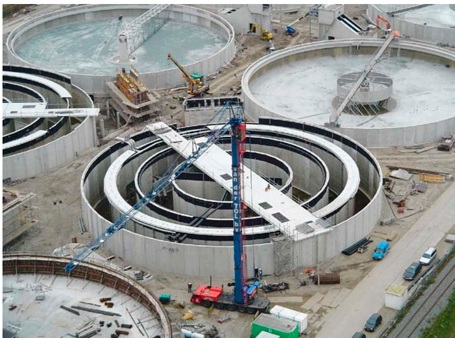
Bodembescherming bij een waterzuivering.
