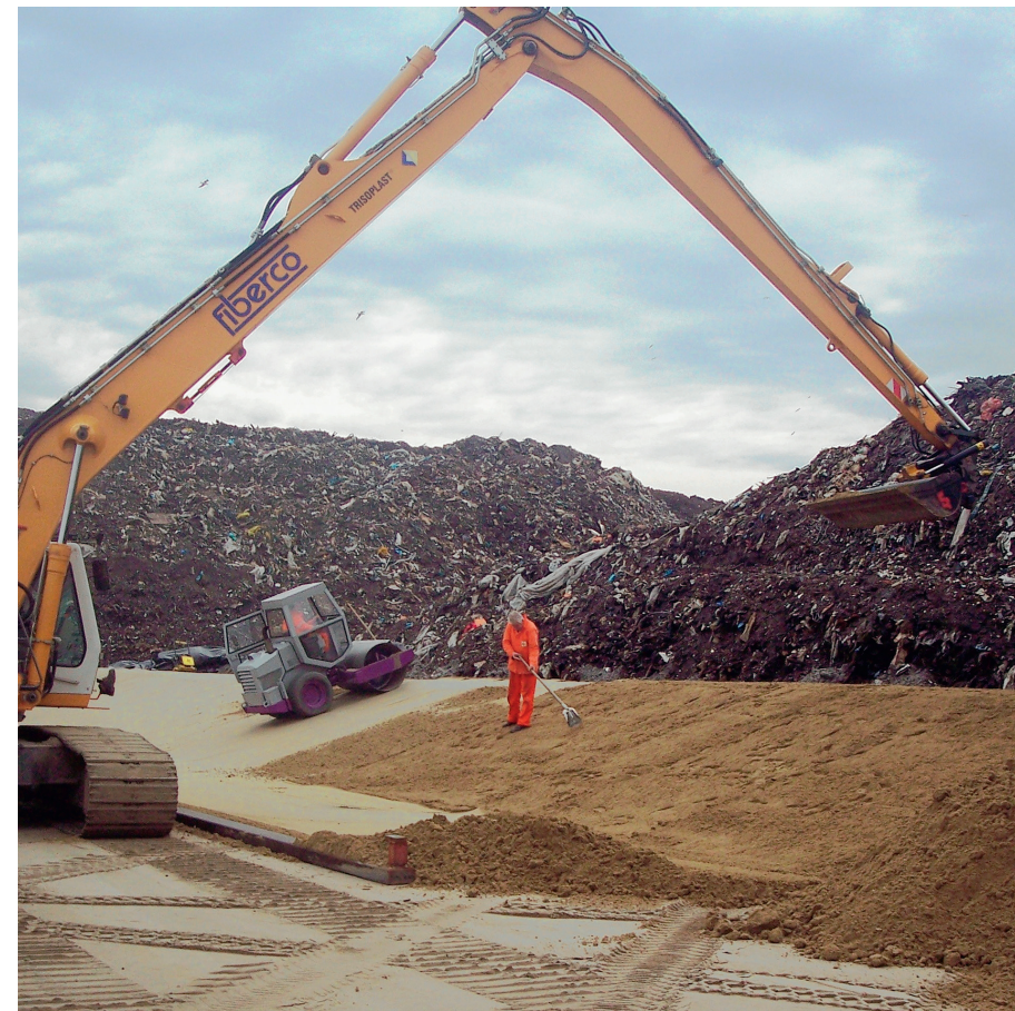
Onderaafdichting voor reststoffenberging.
